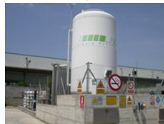
LNG - metano liquido
